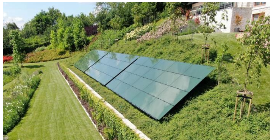
Fot 9 Kolorowe moduły PV zainstalowane na gruncie
