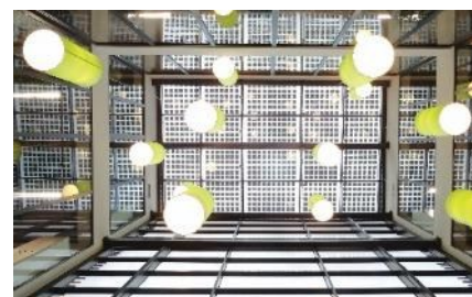
Fot 5 Świetlik fotowoltaiczny
