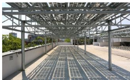
Fot 8 Zadaszenie fotowoltaiczne miejsc parkingowych
